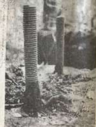
ネジ山の切り込みが、いまもはっきり残っているボルト
